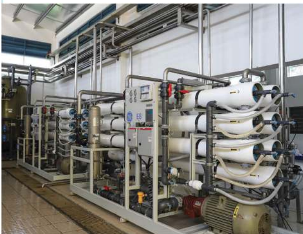
Khu vực xử lý nước nấu Bia
